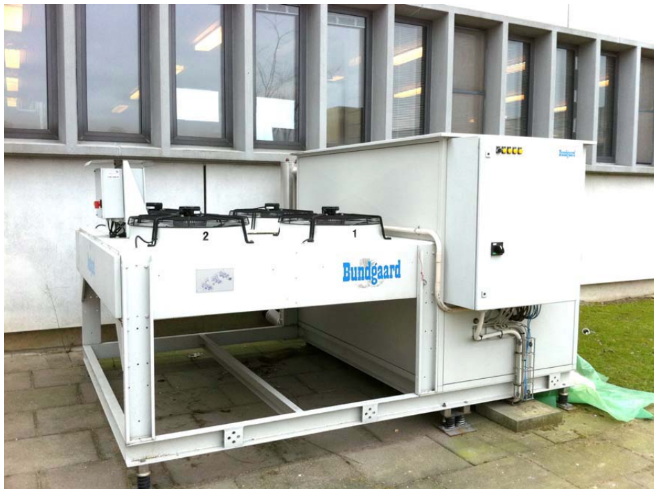
Figur 40 Køleanlæg nord for bygning 8
